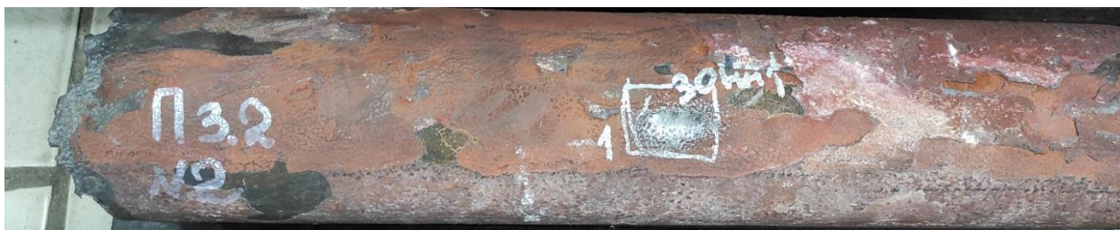
Рисунок 2 – Участок (ПЗ.2 – 2) змеевика печи, демонтирован в 2022 году, имеет повышенное количество выявленных дефектов.
