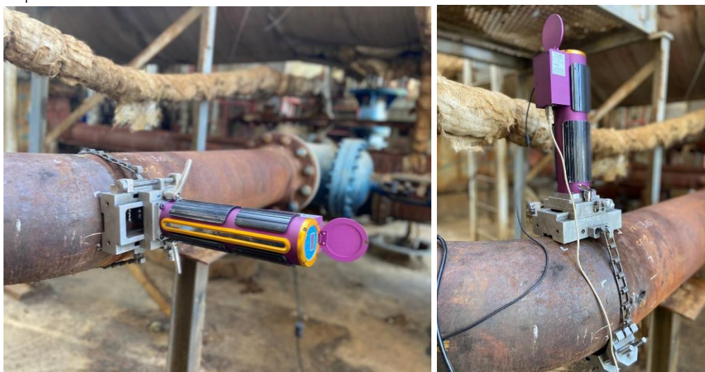
Рисунок 8 - Испытание металла элементов технологической линии 12” P72.315.
