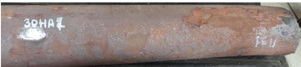
Рисунок 3 – Участок (ПЗ.1) змеевика печи, участок демонтирован в 2020 году.
