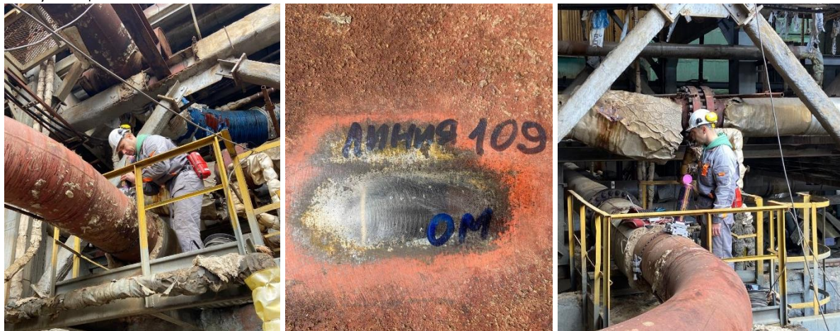
Рисунок 6 - Испытание металла элементов технологической линии 24" P72.109.0.DB16. Испытываемая труба - 18" (А333Gr.6).
